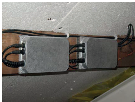
Figuur 6-28. Inverters (voorschakelkasten) op zolder.
