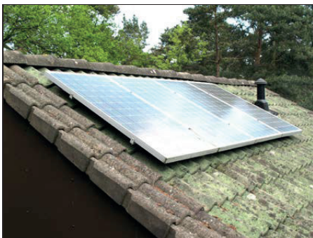
Figuur 6-27. Zonnecellen op het dak (PV cellen).
