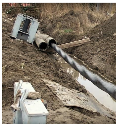
Figuur 3. 150 kV kabel met om elkaar gedraaide bundels fasekabels. Still uit https://tinyurl.com/vc4x8254
