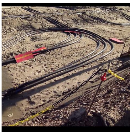
Figuur 2. 150 KV kabels met gescheiden fasekabels Bron: [5]
